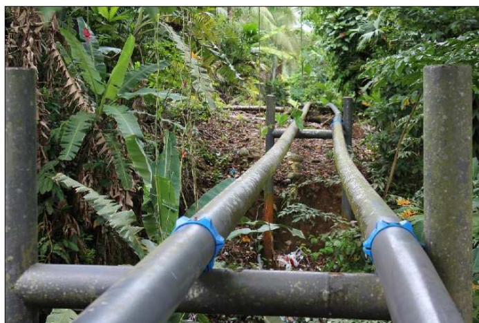
Figura 9.8. Tuberías del poliducto de RECOPE a la altura de la comunidad de Monteverde, Siquirres.
