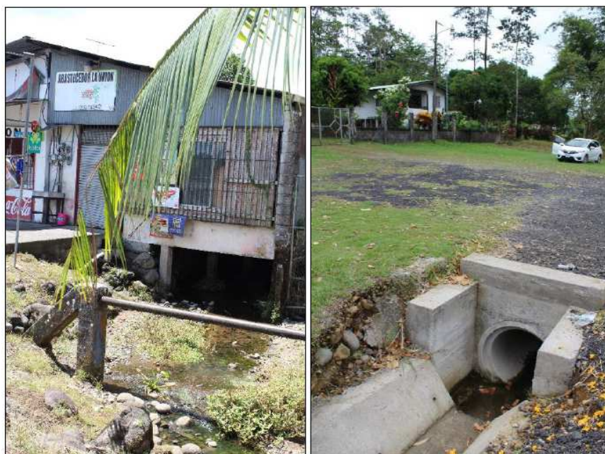
Figura 9.7. Izquierda: Tubería de agua potable que atraviesa la Ruta 32, La Unión de Guápiles. Derecha: Alcantarilla sin paso peatonal, Siquirres, abril, 2016.
