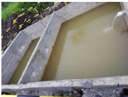
Figura 2. Desagües de segunda y tercera pila muy bajos, sedimentador planta de concreto en campamento Guápiles.
