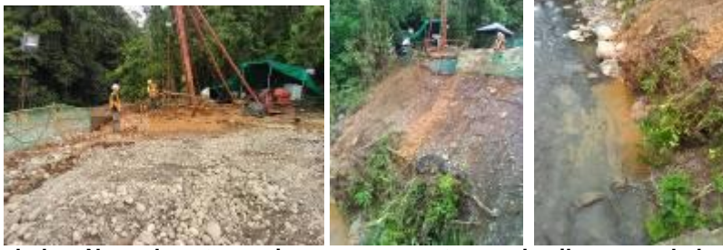
Evento de derrame de lodos. Normalmente comienza por una rotura en la pila o por rebalse por sobrellenado. En estos casos se activan de inmediato los protocolos.
