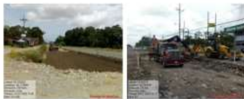
Figure 4. Movimientos en el km 63.
