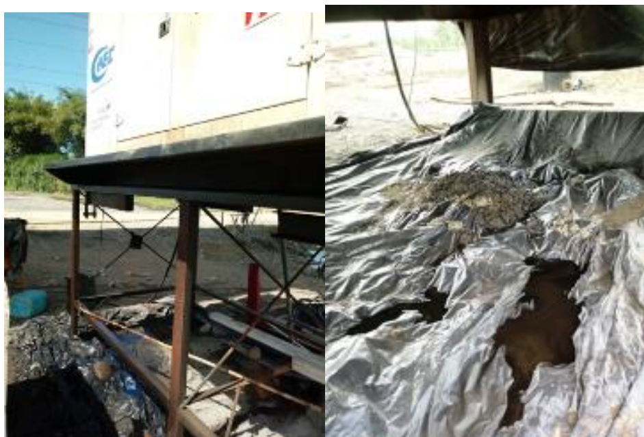
Figuras 33 y 34. Derrames en generadores en Chirripo
