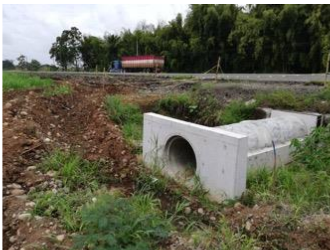
Figura 11. En el K81+767, está esta alcantarilla redonda, en este kilómetro se encuentra el paso inferior cuadrado para el paso del jaguar y otros mamíferos. Se le indica a CHEC que esta alcantarilla no puede ser doble propósito y se debe hacer el paso específico.
