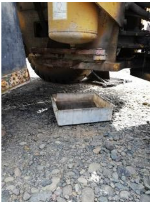
Figura 9. Uso de bandeja de plástico para evitar derrames durante reparación de montacargas en campamento K93.
