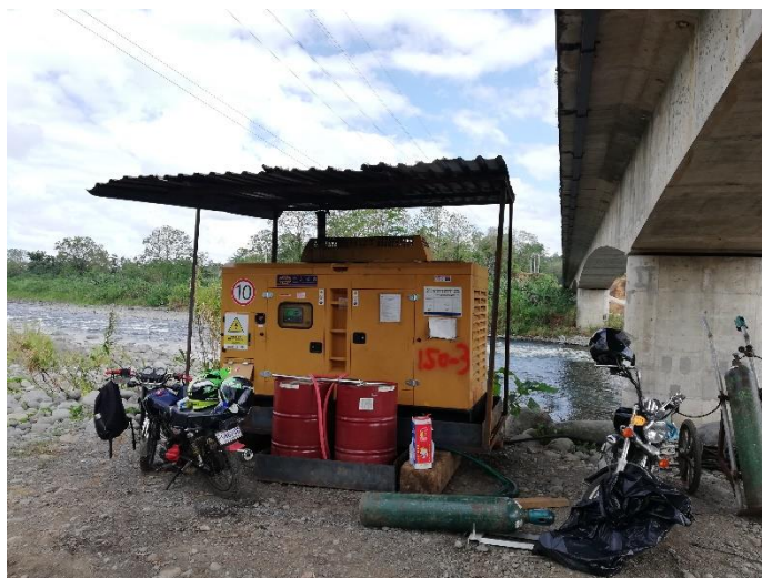
Figura 32. Generador y estaciones de combustible con bandejas contenedoras de derrames y techo. Río Reventazón.
