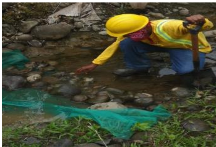
Figura 26. Barrera de contención con sarán para evitar paso de fauna acuática en labores en alcantarillas.
