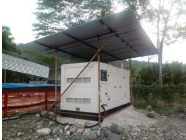
Figura 11. Generador con techo en área de campamento K115.
