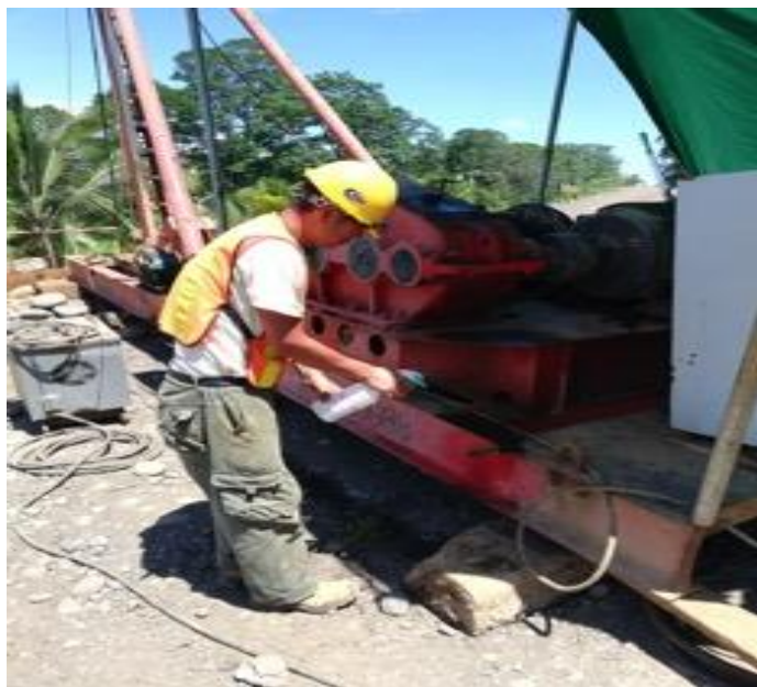
Figura 39. Aplicación de absorbente de HC en perforadora con fugas, río Reventazón.
