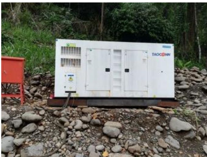
Figura 40. Generador sin techo, Río Pacuare.
