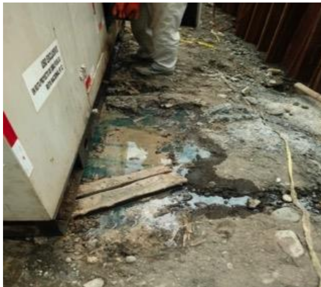
Figura 34. Derrame de diesel en generador en Chirripó. Por esto se tiene abierta No Conformidad.
