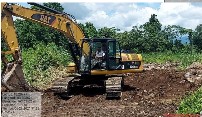
Figura 5. Maquinaria trabajando en propiedad privada y retirada luego de que tomo fotos por reporte de vagonetas de CHEC en el lugar sacando material.
