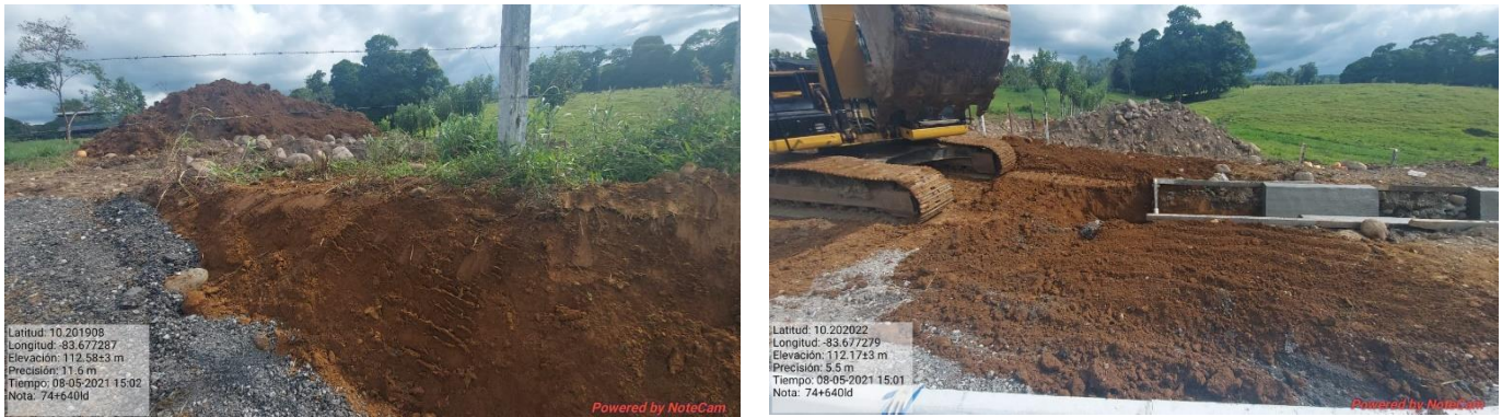
Figura 4. Se monitorea el trabajo que se estaba llevando a cabo en el km 74+558/640
