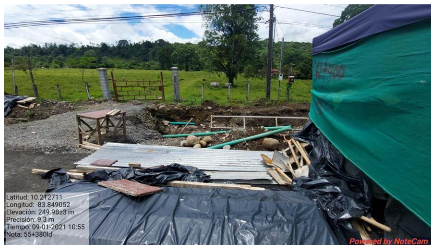
Figura 2. Inspección km 55+380LD en zona sin actividades.
