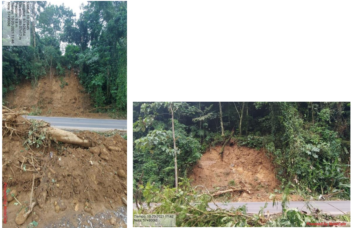
Figura 1. Deslizamientos entre km 57- 58, se hace inspección de materiales caídos
