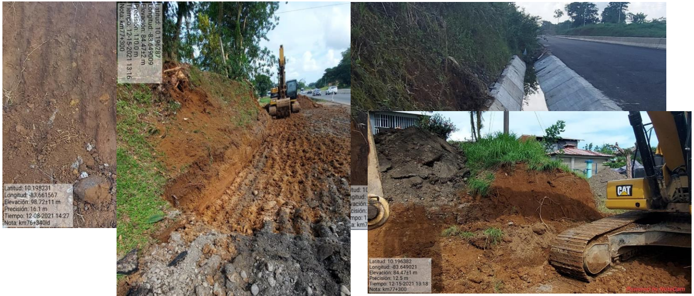
Figura 7. Se da seguimiento al trabajo en este punto del km 77 en el lado izquierdo
