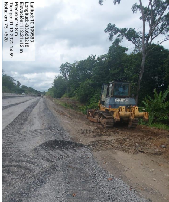
Figura 6. Se hace inspección a lo largo de la vía en este km75+
