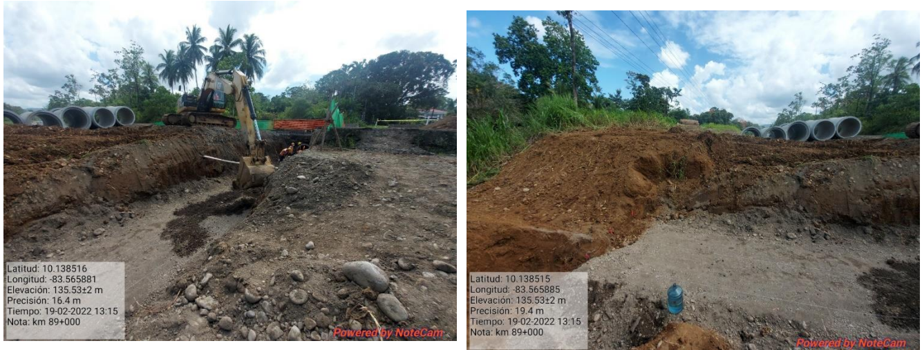
Figura 9. Conformación de paso de fauna km 89.
