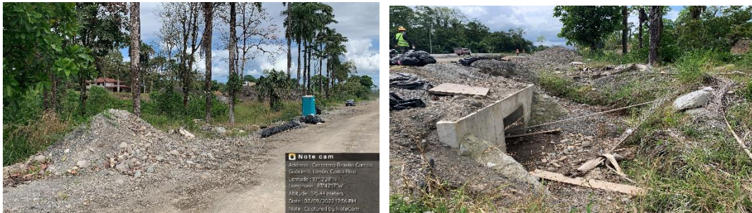
Fotografías 3 y 4: Paso de fauna k71+410 con riesgo de obstrucción en caso de que el relleno que realiza CHEC se extienda hasta este sitio.
