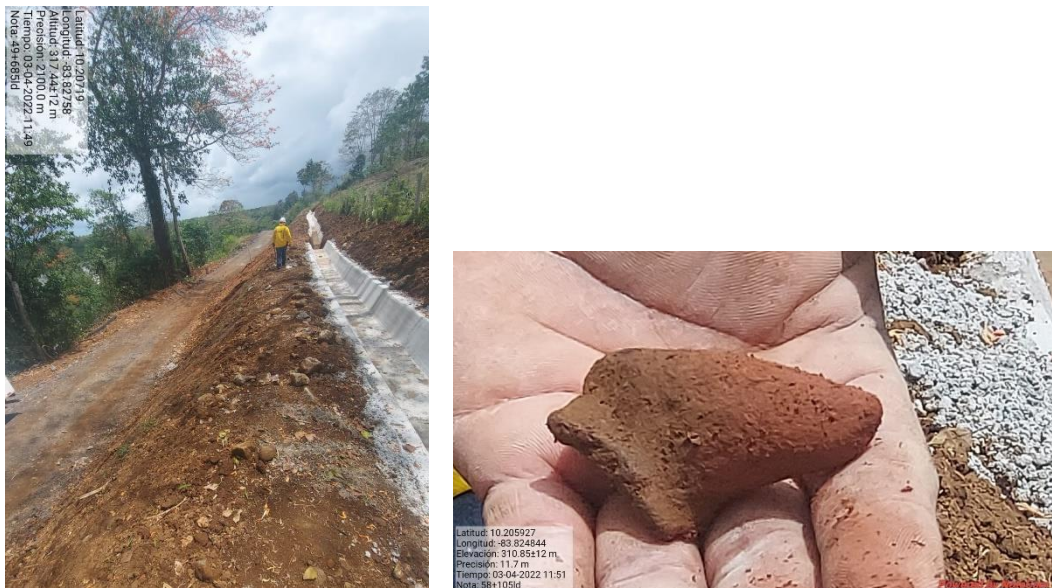
Figura 8. Revisión de área de desagüe en Km 58 y fragmento de soporte ubicado en este sector.
