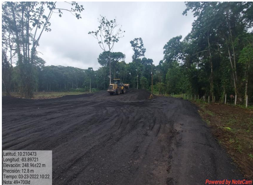
Figura 4. Km 49+680 Material depositado en terrenos internos.
