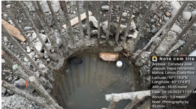
Fotografía 1. Se observan burbujas en el agua acumulada en el pilote, lo que denota la salida de gases.
