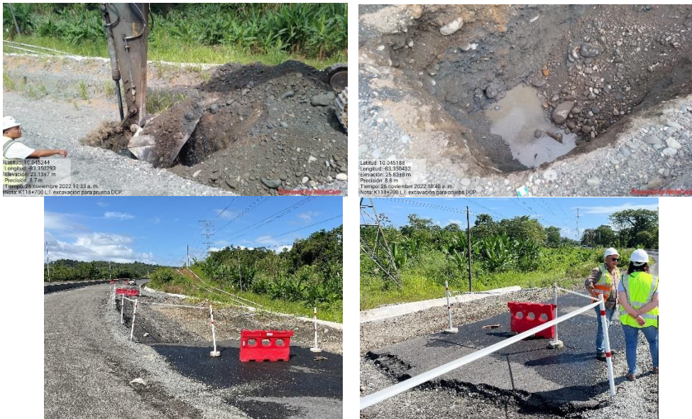
Fotografía 2. Excavación con presencia de hidrocarburos, k118+722.
