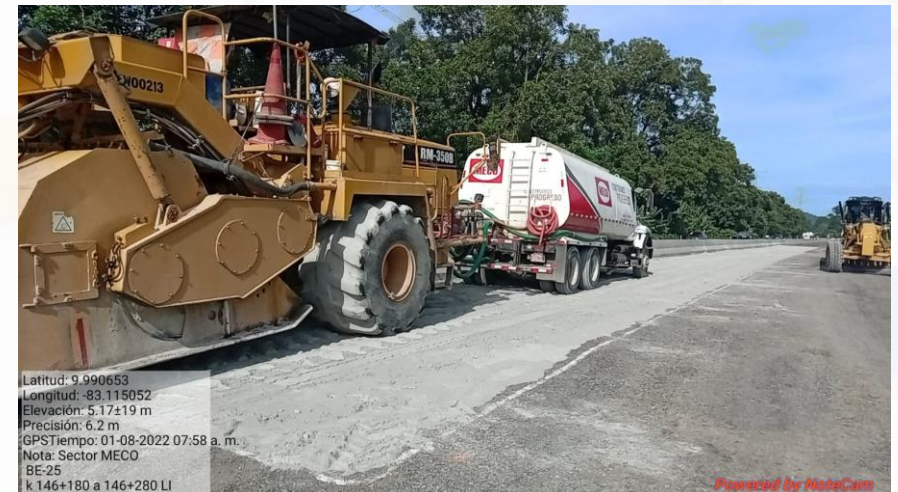
Colocación de capa de base estabilizada con cemento Km 146+180 al 146+280, Lado izquierdo
