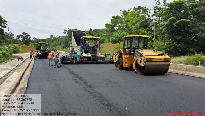
Colocación de capa de mezcla asfáltica en caliente Km 116+160 al 116+440, Lado izquierdo
