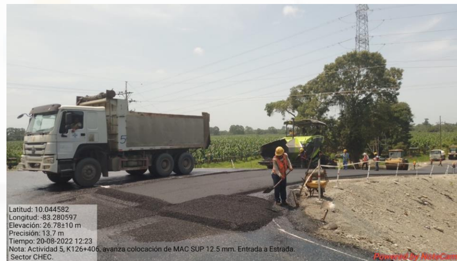
Colocación de capa de mezcla asfáltica en caliente del acceso 126+400, Lado izquierdo
