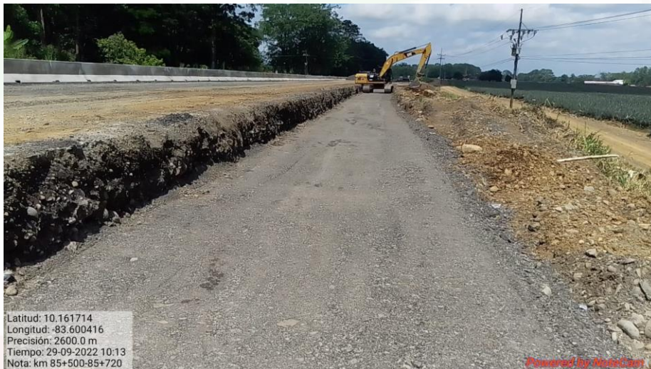
Excavación y sustitución de material para rehabilitación en Km 85+500 al 85+720, Lado izquierdo
