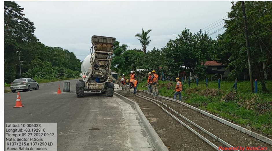
Vertido de concreto de la acera de la bahía de autobús Km 137+215 al 137+290, Lado derecho
