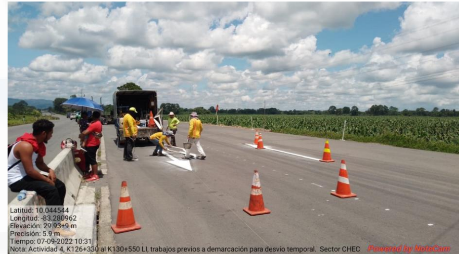
Demarcación vial en el Km 126+330 al 130+550, Lado izquierdo
