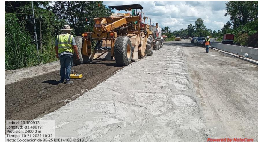
Colocación de capa de base estabilizada con cemento Km 101+160 al 101+210, Lado izquierdo
