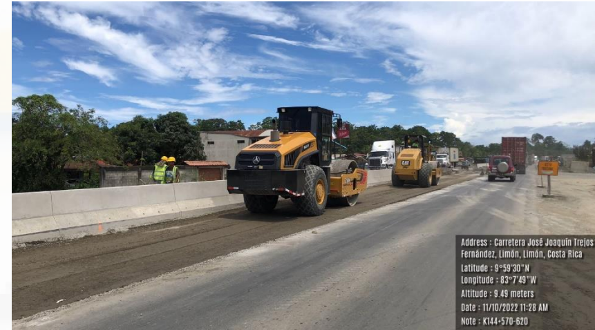
Colocación de capa de base estabilizada con cemento Km 144+570 al 144+670, Lado izquierdo
