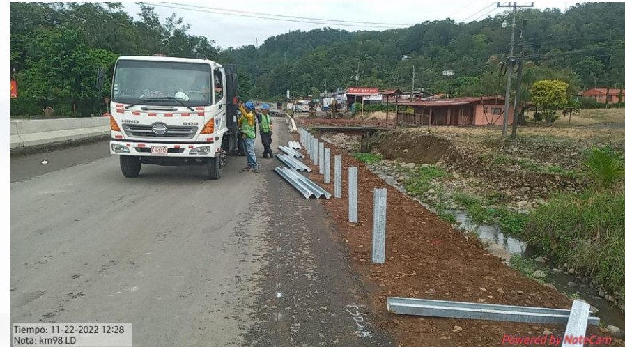
Colocación de la barrera Flex Beam en el retorno del Km 98+000, Lado derecho
