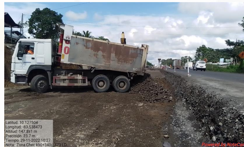
Relleno en Km 90+340 al 90+470, Lado derecho
