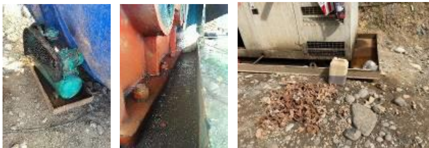
Fot. Izquierda: Compresor debidamente colocado en una bandeja, para contener cualquier derrame que pueda ocurrir ya sea de aceite o combustible. Centro: Pilotera N°12 en río Reventazón con fuga de aceite, la cual está siendo colectado en la bandeja. Derecha: En plantel Barbilla, se observa contenedor de HC fuera de área impermeabilizada, o bandeja de contención y sin techo.
