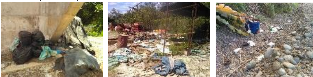
Fot. Izquierda: Km 51+000 Río Corinto, hay muchos residuos sólidos. Se debe poner orden y limpieza en los frentes de trabajo especialmente procurar dejar los sitios limpios una vez concluidas las actividades. Centro: En K93 hace falta orden y limpieza, se han movido algunas máquinas piloteras y sus accesorios, dejando un área de trabajo en desorden y con muchos residuos ordinarios. Se debe realizar la limpieza del área de trabajo, gestionar adecuadamente los residuos peligrosos. Derecha: Km 125+900, el basurero tiene varios días sin recoger y hay basura fuera del recipiente, al alcance de roedores y animales callejeros y materiales fácilmente dispersados por el viento: plásticos, poliestireno.
